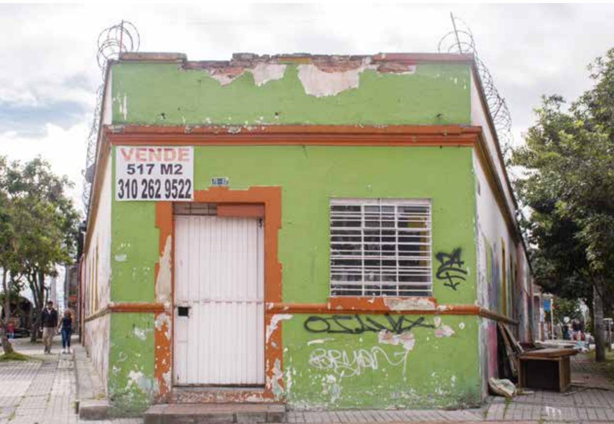
DETERIORO ARQUITECTÓNICO PRODUCTO DE LA AMPLIACIÓN DE LOS CORREDORES VIALES DE LAS TRONCALES DE TRANSMILENIO POR LA AVENIDA A MEDELLÍN (CALLE 80) FUENTE: 2020. CAMILO RODRÍGUEZ-IDPC
